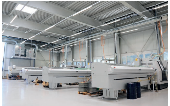
Ölnebel Hallenluftreinigungssystem und Klimatisierung in der Präzisionsmechanik
